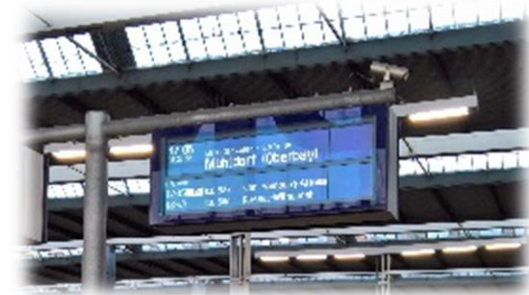
Abb. 4: DB Bahnsteiganzeiger mit Folgezügen
